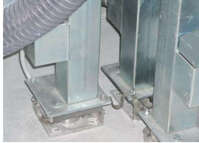
■ Czujniki wagowe umieszczone pod nogami silosów
